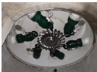
Roda da turbina e injetores e gerador.
